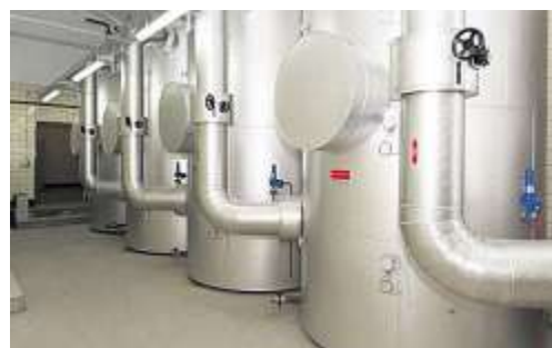
Il calore in eccesso è immagazzinato in speciali accumulatori nelle cantine di Feldschlösschen.
